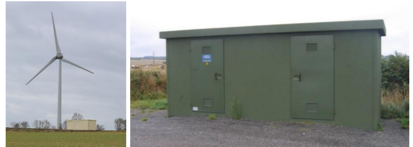
Figure 5 : Exemples de poste de livraison électrique
